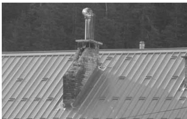
Cheminée endommagée Vallée de l'Ubaye
