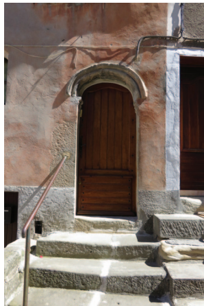
Mise en valeur des piliers d'encadrement pierre possible avec enduit à pierre vue
