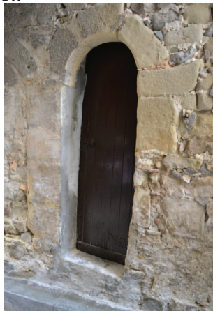
Réparation ou changement de pierres d'encadrement à prévoir et reprise d'enduit pour protection du mur
