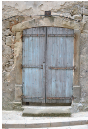
Réparation ou changement de pierre d'encadrement à prévoir et reprise d'enduit pour protection du mur
